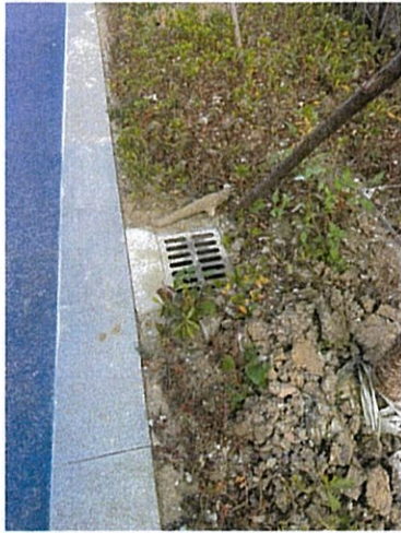
2021. 11. 24 雨水井（道路及配套设设施区）
